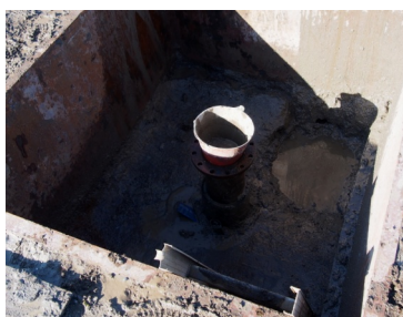
地下1500メートルの源泉が汲み出されるパイプ
